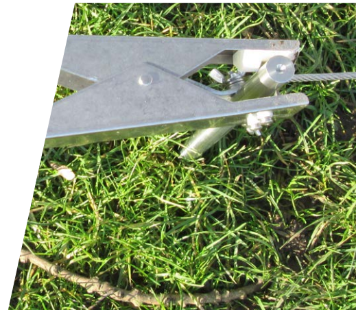
Im Lieferumfang des Earth-Rite II MGV-Systems enthaltene Erdungsklammer befestigt an einem eingegrabenen Erdungsstab
